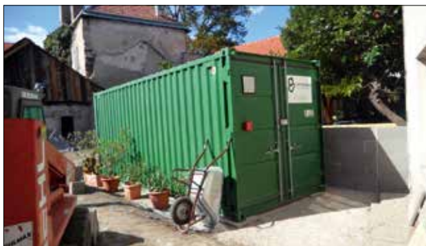
Mit der Filteranlage im Container
